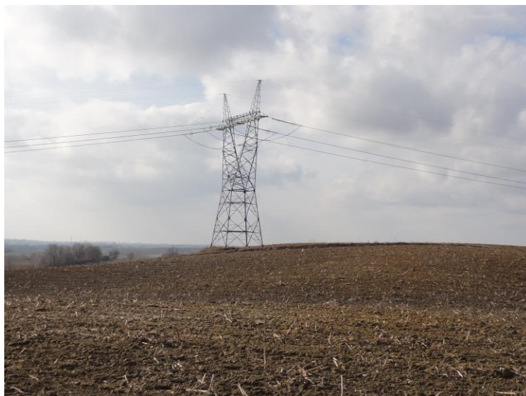
Fot. 17 Linia wysokiego napięcia 400 kV południowa część gminy
